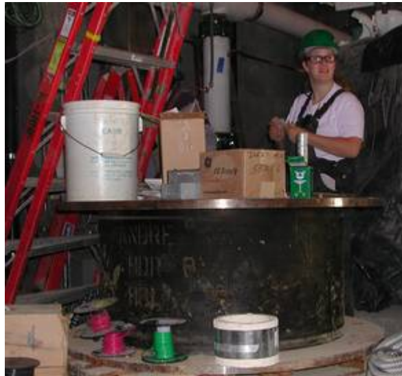
Appui parasismique mis en place sur en sous face de la bibliothèque de Berkeley – Photo de Marc BOUCHON
